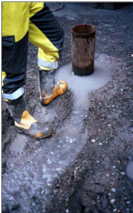
Figur 7-4 Inläckage av vatten efter foderörsborrning, Foto taget vid projektet "Dubbelspår Sandvika – Asker", Norge (Karlsrud, K., Langford, J., Lande, E. J., Baardvik, B., 2015)
